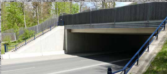
BARRIÈRES DE SÉCURITÉ
